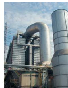
電気炉集塵設備
