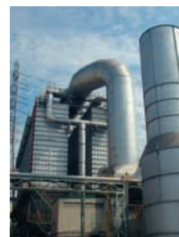
電気炉集塵設備
