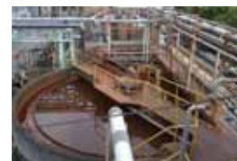
排水処理施設
