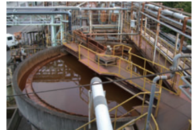
排水処理施設
