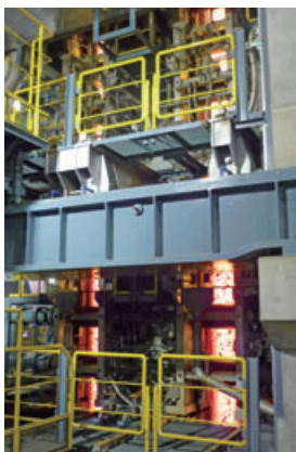
60トン連続鋳造設備
