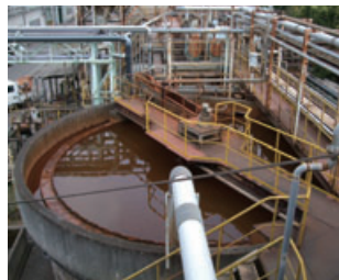
排水処理施設
