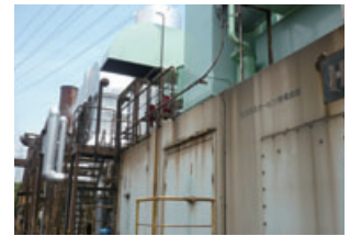
自家発電設備
