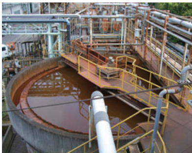
排水処理施設
