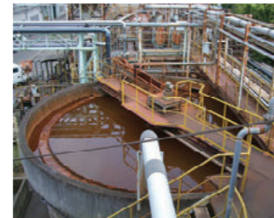
排水処理施設
