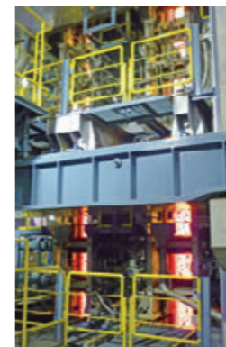
60トン連続 casting 設備
