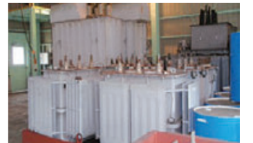
保管倉庫にて、PCB廃棄物を保管・管理
