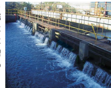
排水処理施設
