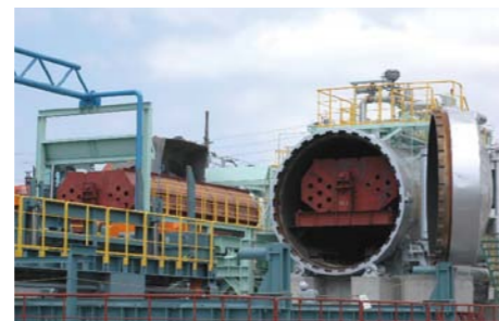
加圧式蒸気エージング設備
