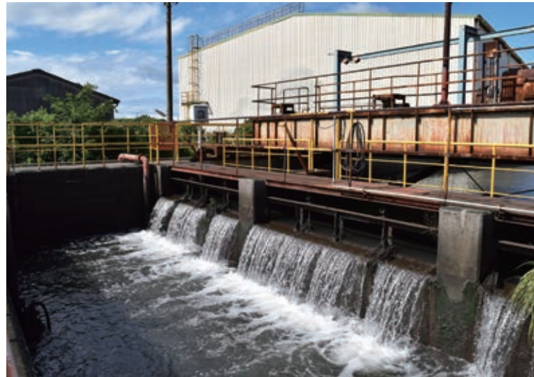
排水処理施設
