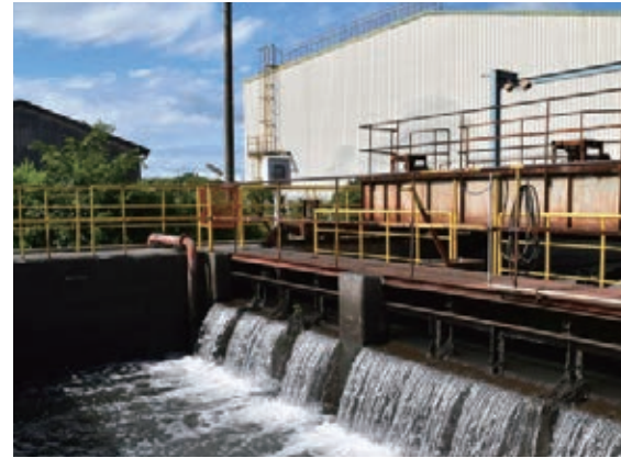
排水処理施設
