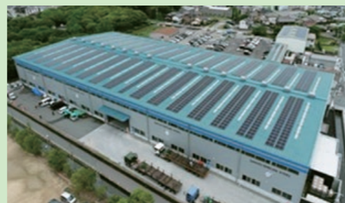
製品倉庫屋上の太陽光発電設備
