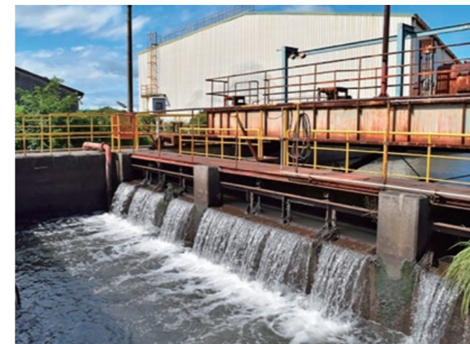
排水処理施設
