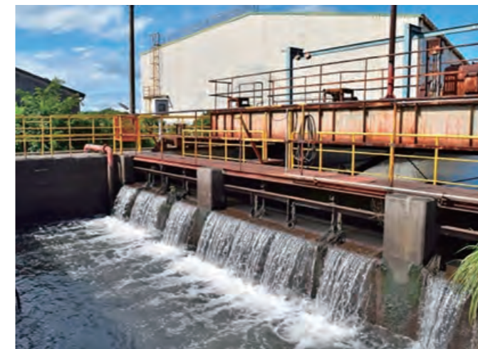
排水処理施設
