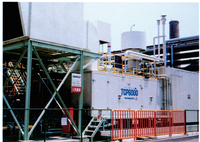
図1 TCP 6000ガスタービン発電装置外観
