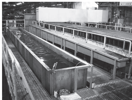
図3 増設した酸洗槽
